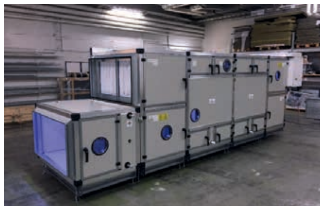
Prezračevalna naprava logističnega skladišča VOLVO Göteborg
