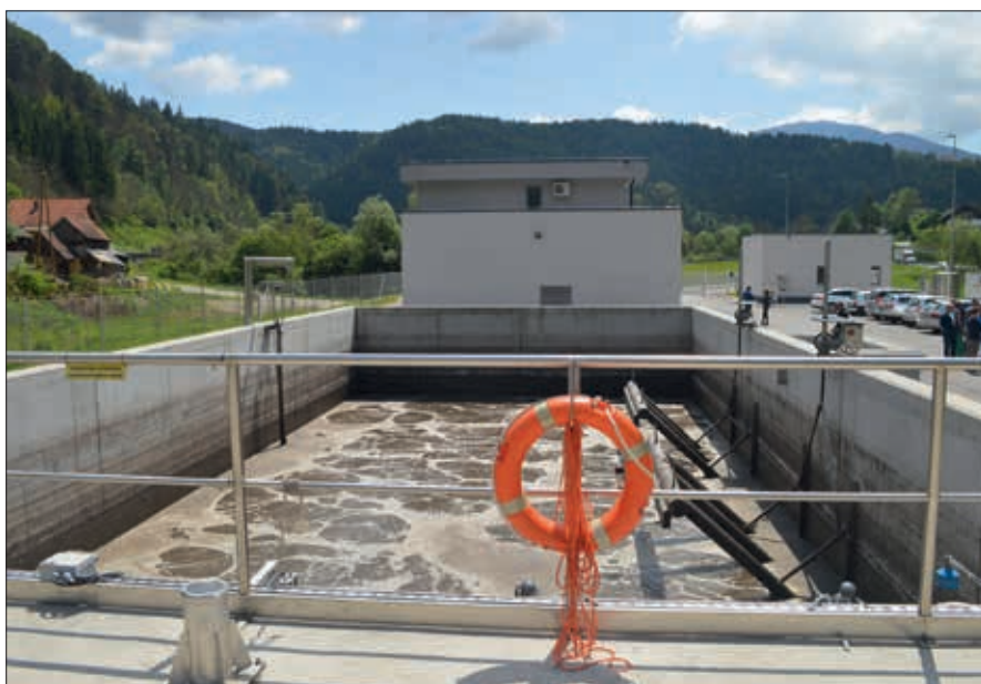
Slika 2: komunalna čistilna naprava Ravne na Koroškem
