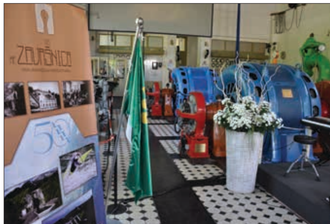
Deset let je hidroelektrarna Završnica spomenik tehniške dediščine. Foto dr. Drago Papler
