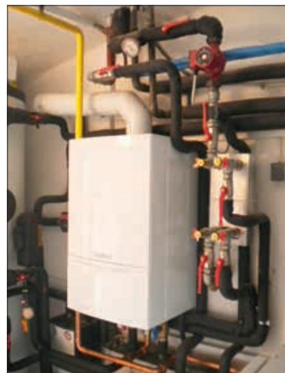
Plinski kondenzacijski kotel in medizmenjevalec
