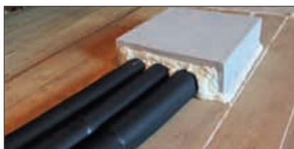
Slika 2: Izolirane dovodne cevi, skupaj z umirjevalno komoro.
