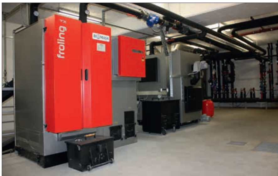
Kotlovnica s kotlom na lesne sekance Fröling, ki ogrevata OŠ in Eko vrtec v Šentrupertu na Dolenjskem
