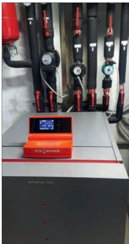
Regulacija toplotne črpalke, vstop vira na levi, ogrevanje na sredini, primarni vod ogrevanja sanitarne vode na desni
