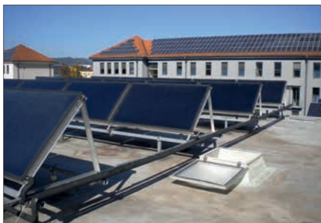
Slika 4: Kolektorsko polje na strehi objekta
