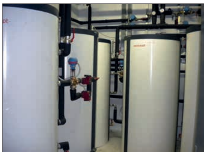
Slika 5: Hranilniki toplote v kotlovnici
