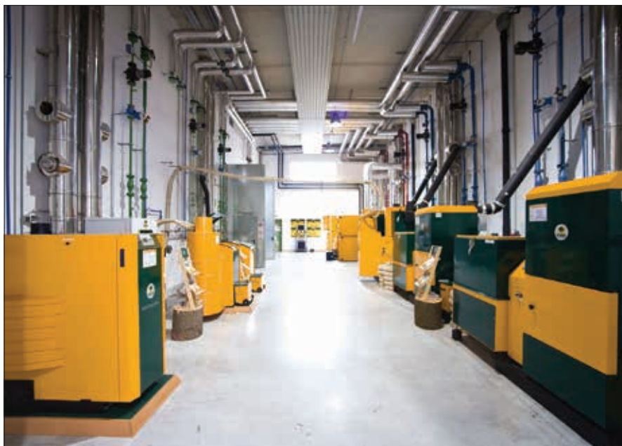
Postopek testiranja kotlov na biomaso, oddelek za raziskave in razvoj, Inovacijski center KWB
