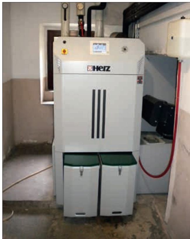
Slika 4: Ogrevalni kotel HERZ Firematic 100
