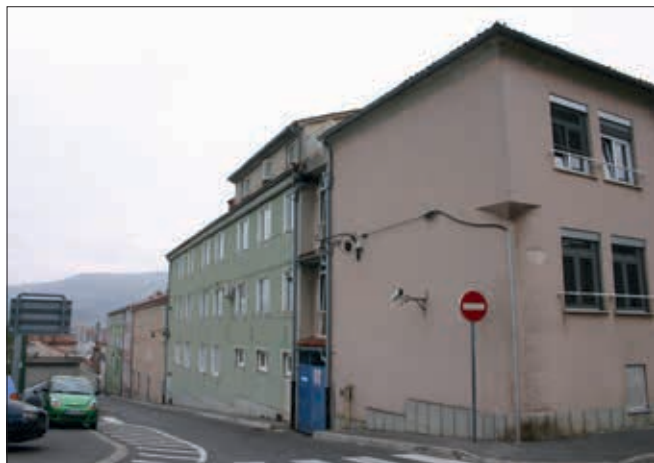
Slabo stanje fasade pred energetske sanacijo.
