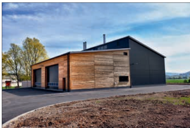
Daljinski sistem ogrevanja na lesno biomaso v zaporih Dob
