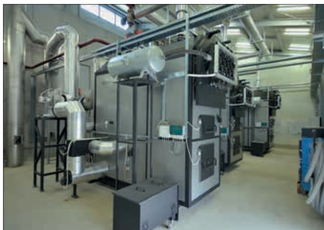
Kotlovnica z vgrajenimi kotli Fröling skupne moči 2,5 MW
