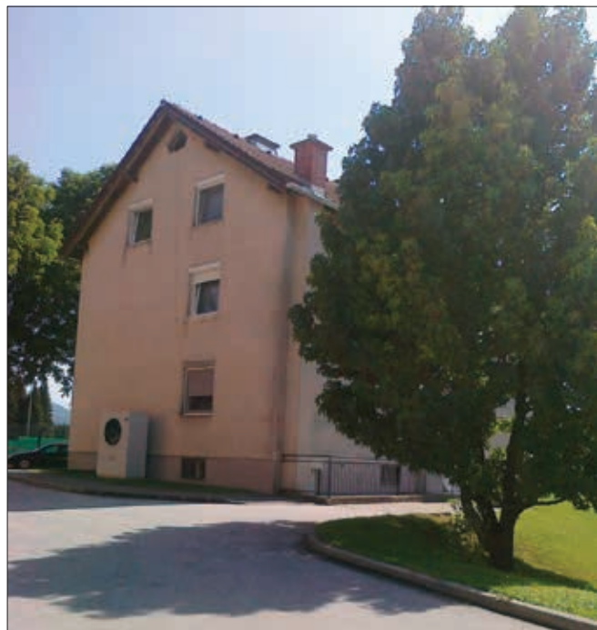
Ogrevanje večstanovanjskega bloka z visokotemperaturno TČ zrak/voda.
