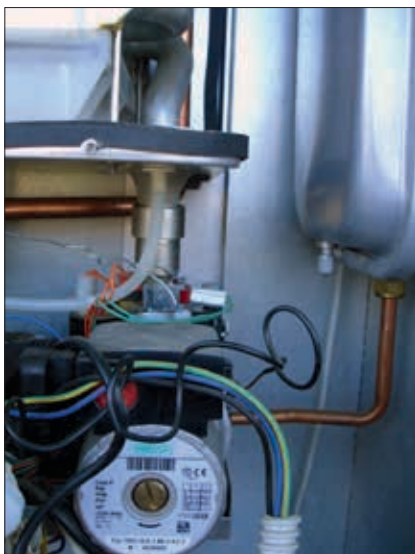
Primer kotla z aluminijastim prenosnikom toplote, ki je v ogrevalni sistem povezan z bakrenimi cevmi.
