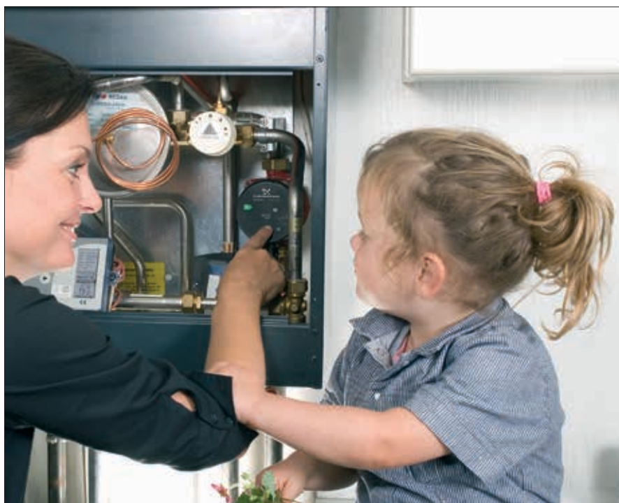
Vgrajena črpalke Alpha2 v običajnem gospodinjstvu
