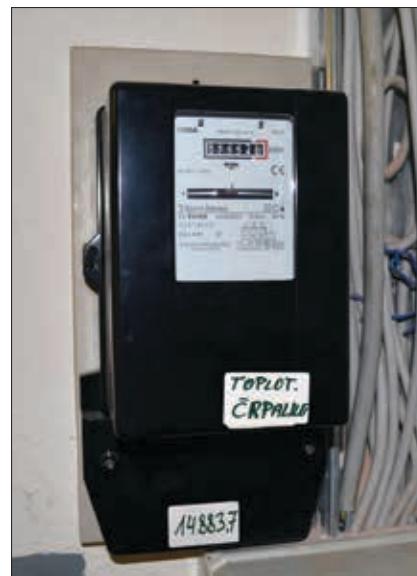
Odštevni števec – stanje števca ob vgradnji in stanje sedaj
