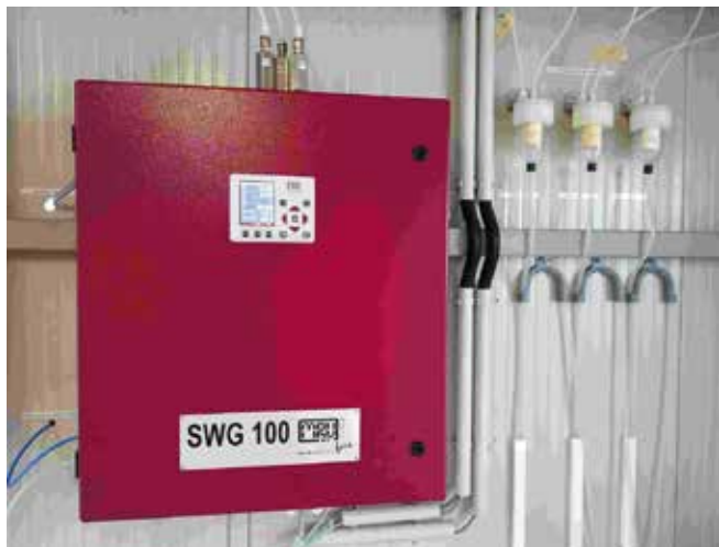
Sistem MRU SWG 100 biogas - 3 merilna mesta
