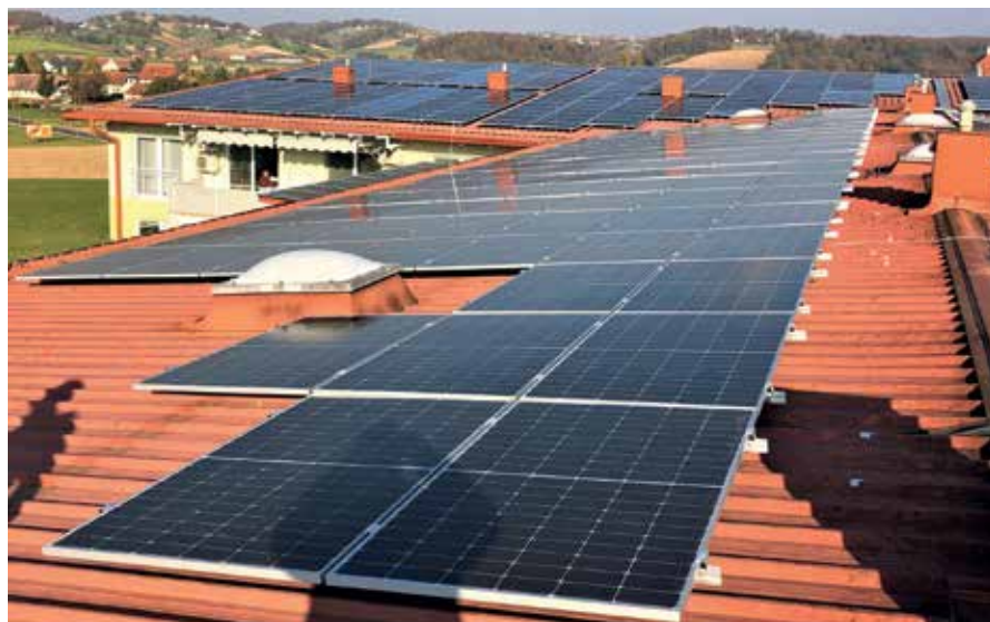
Na strehi Dom Lenart je nameščenih 1.112 modulov v skupni vršni moči 328 kW.
