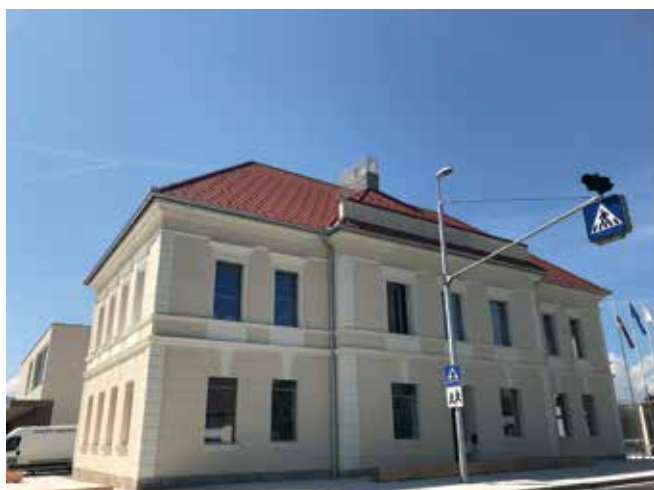
Notranja izolacija Multipor v OŠ Cerklje ob Krki, ki spada pod varstvo kulturne dediščine.
