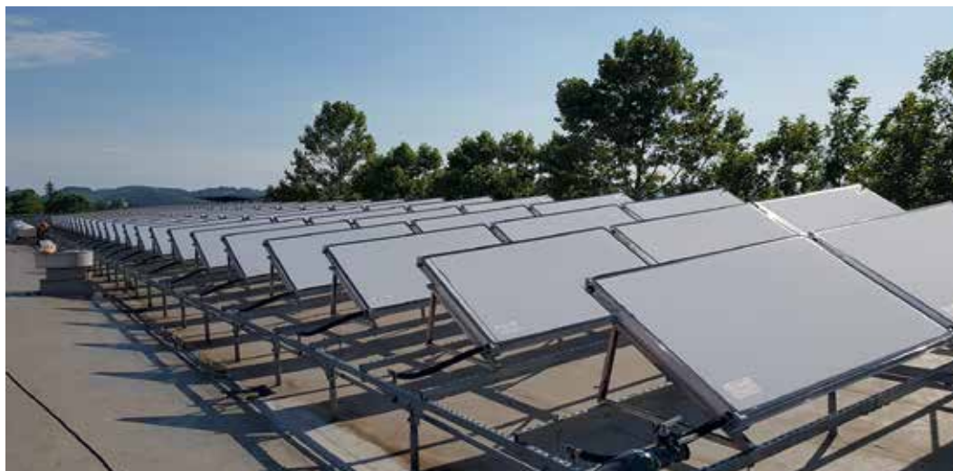
Slika 4 Kolektorji so vgrajeni na strehi poslovne stavbe
