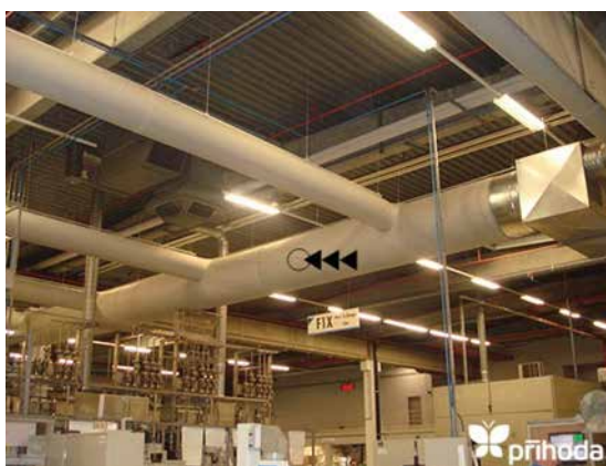
Zaradi enostavnega čiščenja so tekstilni kanali še posebej primerni za prehrabno industrijo.
