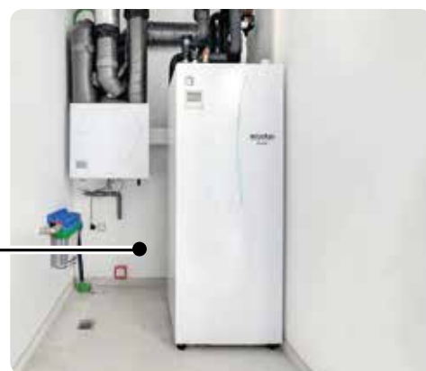
Ecodan Cylinder, vodna enota toplotne črpalke z integriranim rezervoarjem sanitarne vode in centralizirana prezračevalna naprava z rekuperacijo toplote Loosnay VL-CZPVU
